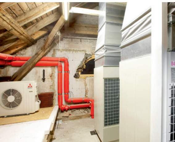
Innen aufgestellte Außengeräte im Dachstuhl des Hotels. Die Fortluftkanäle sind mit flexiblen Stützen mit dem Gerät verbunden
